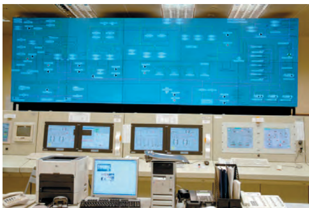
Рис. 4. Общий вид щита управления КП ЖРО
