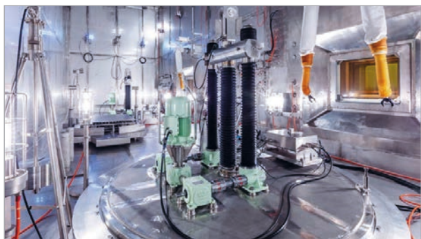
Рис. 5. Перегрузочное оборудование для ВАО (Цвилаге)
